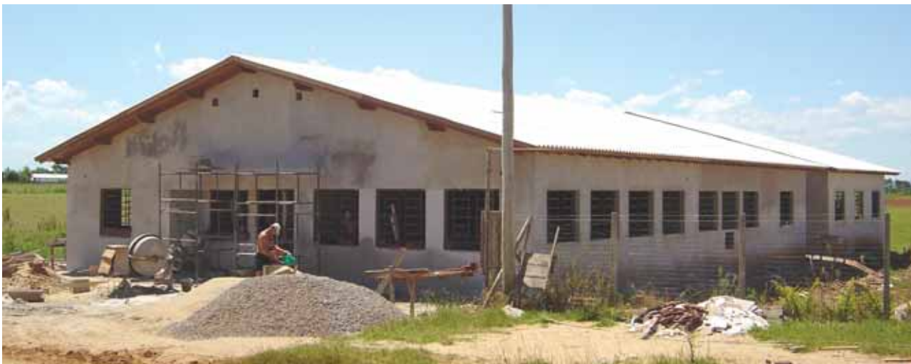
Obras da nova sede de Albardão, construída por jovens do Cedejor e moradores locais
